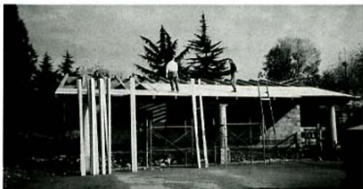
Un momento dei lavori per la posa del tetto alla nuova sede degli alpini.
